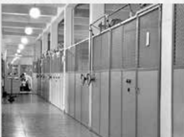
1940: A lakihegyi 135 kW-os adó erősáramú berendezése.
